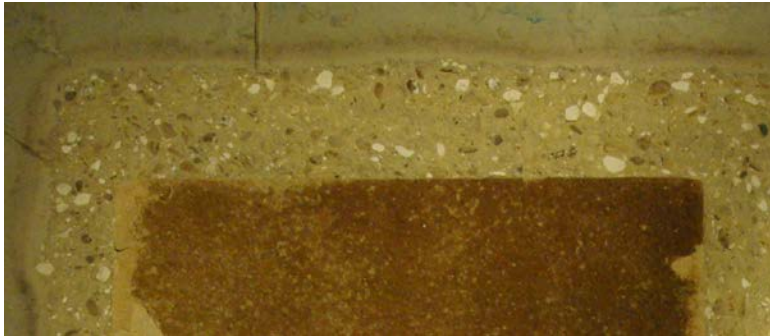
Bild 33: keine Abplatzung des Traggrundes da Beton mit PP Fasern vergütet
