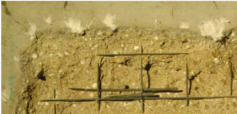
Bild 32: Abplatzung des Traggrundes
